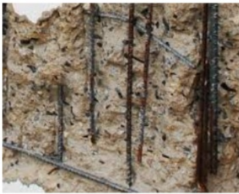
(a) kerusakan selimut beton akibat korosi tulangan geser
